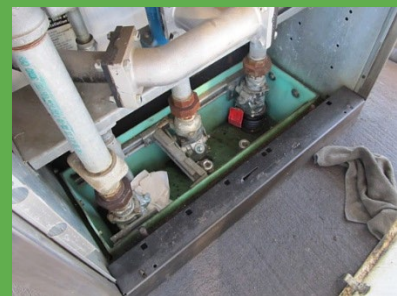
Contención bajo dispensador
