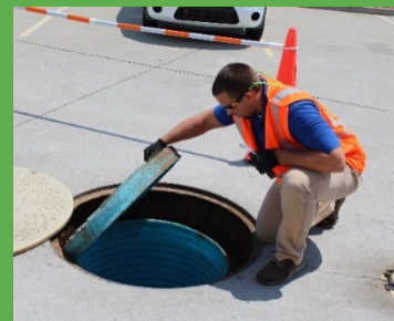
Cómo inspeccionar un pozo de contención
